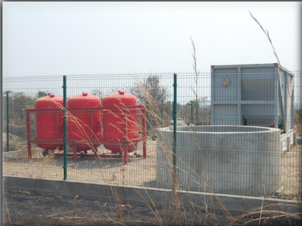
Armazenamento e purificação da água no Lobito, Angola
