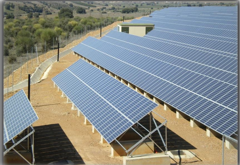
Protecção perimetral numa unidade solar em Ciudad Real, Espanha
