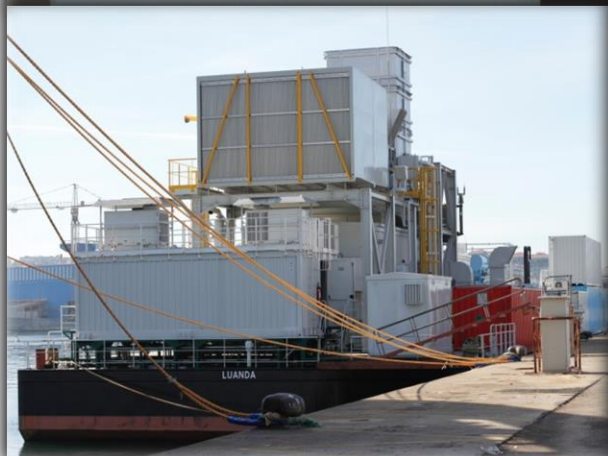
Central termoelétrica de 42 MVA em barçaça em Caxito Angola
