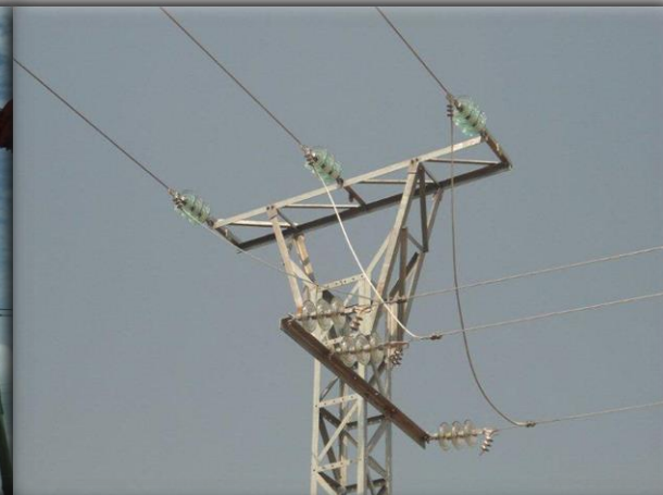
Torre da linha de distribuição em Lucapa, Angola
