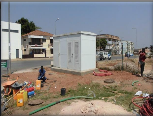
Estação transformadora no Catete Angola
