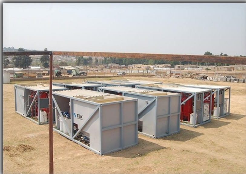
Unidades de potabilização em contentores na loja do Huambo, Angola
