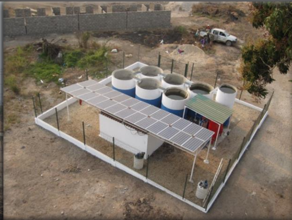
Estação de Potabilização com abastecimento fotovoltaico em Qunizau. Zaire, Angola
