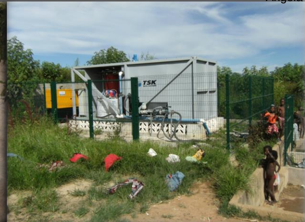
5m3/h unidade de purificação de água em Chipipa, Angola
