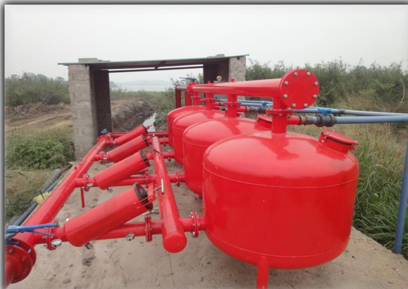
Sistemas de filtragem em áreas isoladas. Angola
