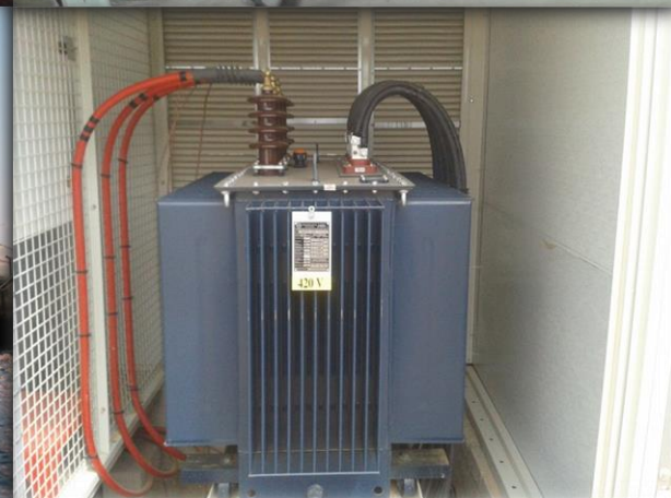
Transformador em Cambambe, Angola.
