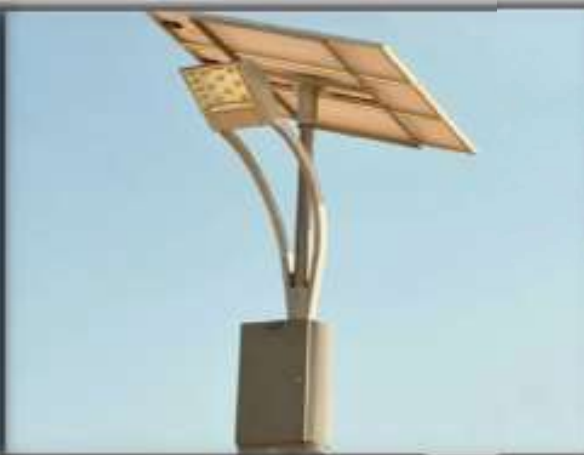
Iluminação pública fotovoltaica em Malanje, Angola
