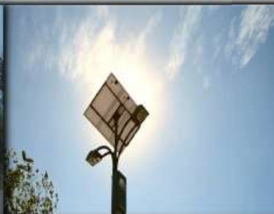
Detalle de Iluminación fotovoltaica en Lubango,Huila
