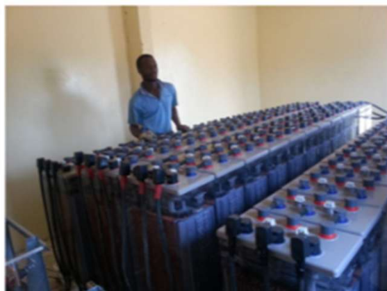
Instalação de baterias para alimentação potabilizadora de água. Província de Huambo.
