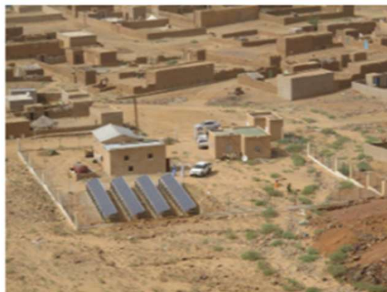
Instalação fotovoltaica híbrida em Mauritania.
