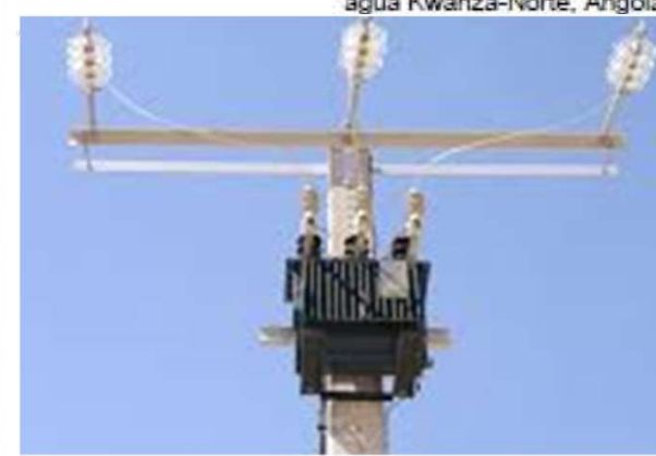
Puesto de transformación rural en la provincia de Luanda
