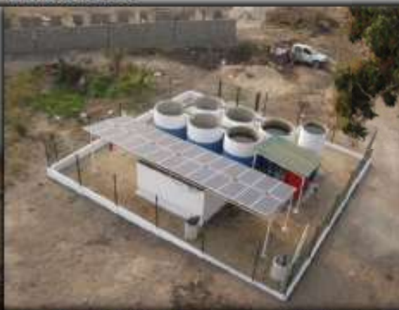
Estación potabilizadora con alimentación fotovoltaica Provincia de Zaire
