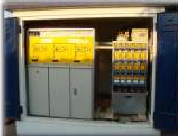
Puesto de transformación en Matsi, Huila
