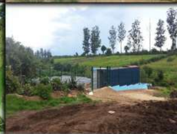
Estación potabilizadora con alimentación solar en el parque Nacional de Cameia.
