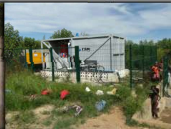
Estación Potabilizadora en Chipipa, Huambo
