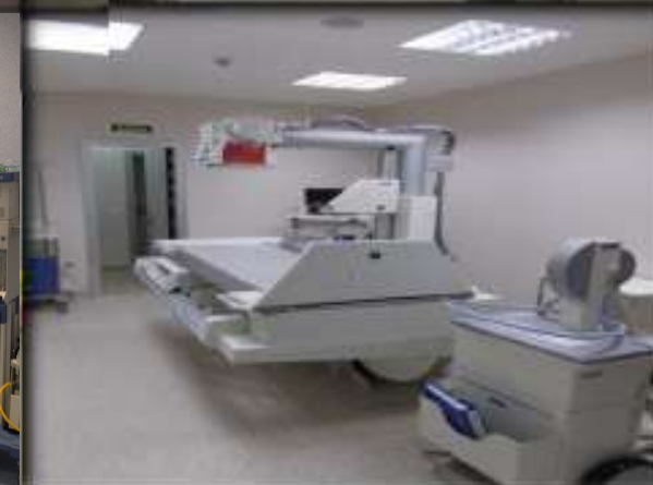
Equipamiento unidad de radiología
