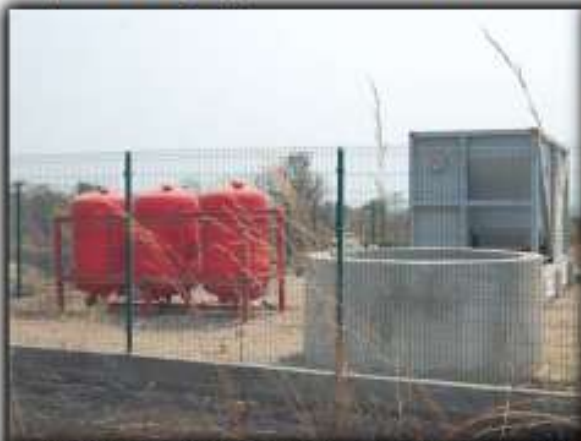
Depósitos de água y potabilizadora en Lobito
