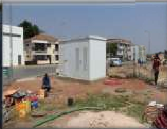
Centro de transformación en Cateia
